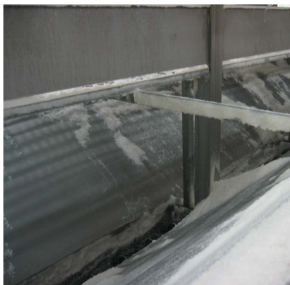
Bilde 6: Oppsamler under ristene
